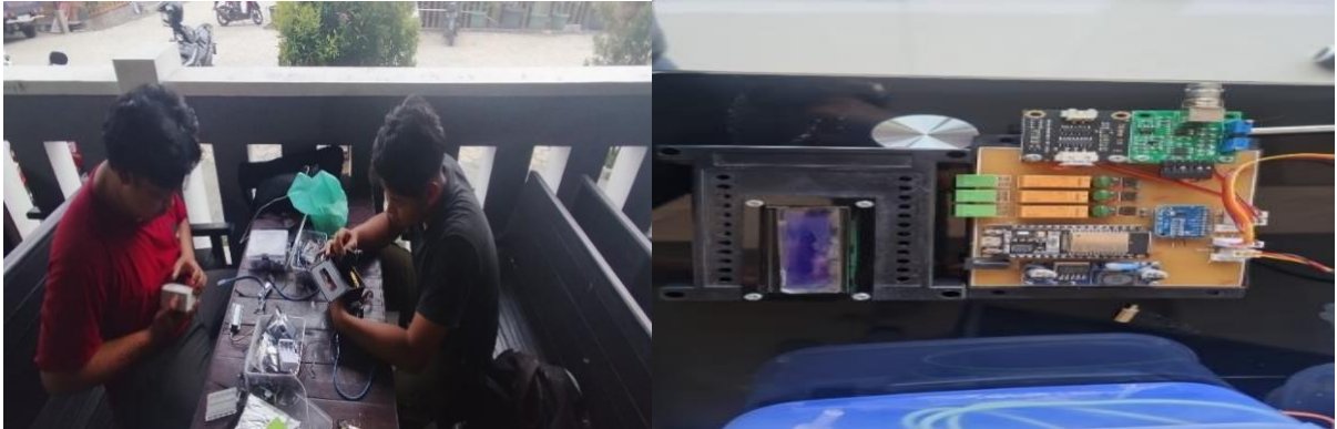
Gambar 3 : Perakitan instalasi IoT pembenihan ikan lele
